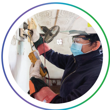
Dự án “An toàn điện”
